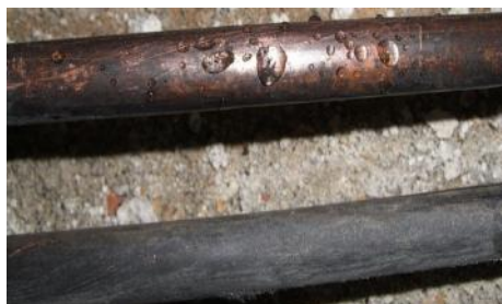
Beschadigde hydraulische leiding
