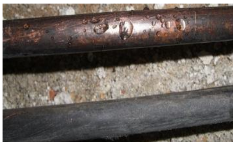
Beschadigde hydraulische leiding
