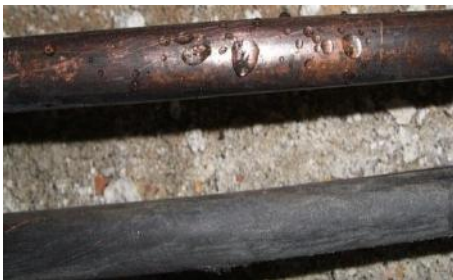
Beschadigde hydraulische leiding
