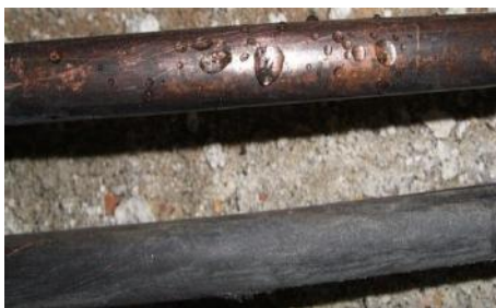
Beschadigde hydraulische leiding
