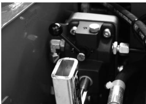
Fig. 155 Handbediende tuimelschakelaar handpomp
