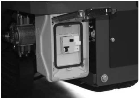
Fig. 163 Automatische magnetothermische schakelaar
