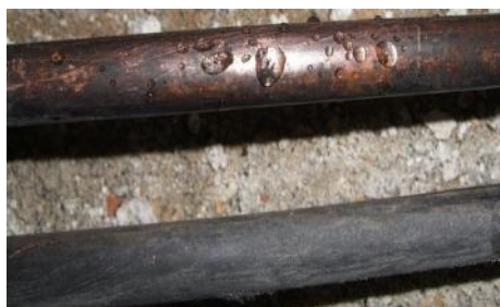
Beschadigde hydraulische leiding
